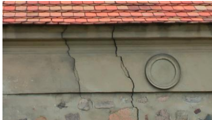
Foto Riss Mauer
